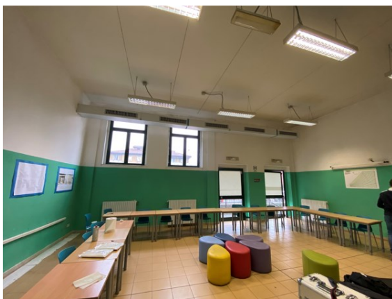
Figura 11 - Aula TER.2 e condotta di mandata dell'aria
