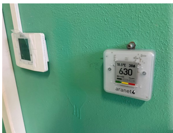
Figura 10 - Aula TER.2, particolare sensore CO 2
