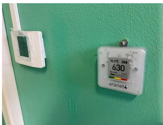
Figura 10 - Aula TER.2, particolare sensore CO 2
